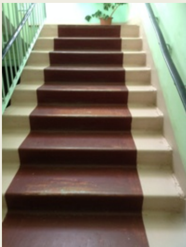
Лестничные проёмы до ремонта
